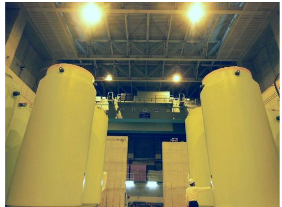
(茨城県にある東海第二発電所の乾式キャスク)
